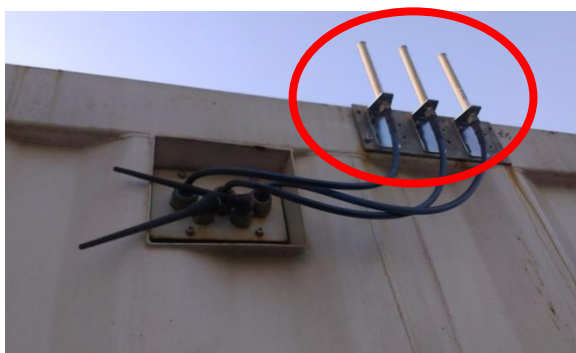
柜外安装的天线
